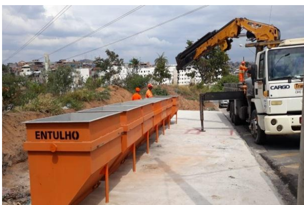
Figura 02: Caçambas do Programa Ecoentulho sendo dispostas em um ponto da cidade em que havia descarte irregular de RCC. Fonte: Autor, 2018.
